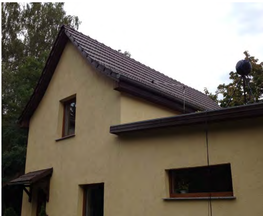
Bild 4: Gebäude mit Aktenzeichen 07540 - Tre - XXTN - 08 W, 1. Obergeschoss, Messpunkt Dachschräge A4.4 (Foto von der Ortsbesichtigung am 26. Aug. 2015)
