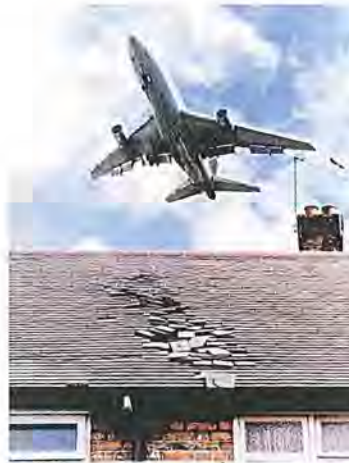
Bild 7. Von Wirbelschleppen verursachte Dachschäden an Häusern in der Einflugschneise des Flughafens London-Heathrow (aus Blackmore 5 ).
